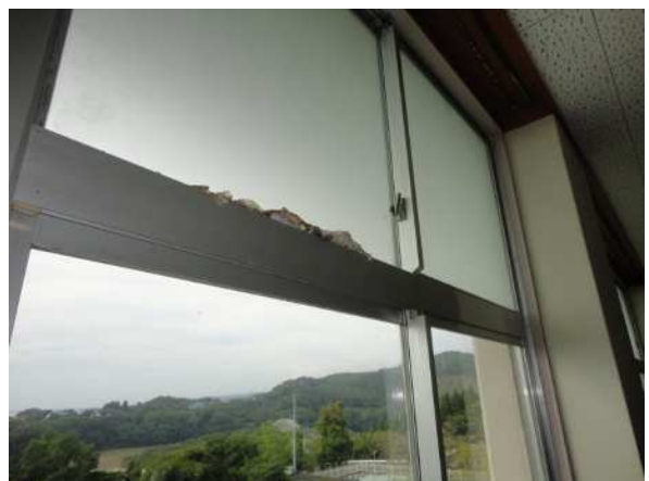
一部雨水の吹き込み跡あり 3階その他の南側サッシも同様
