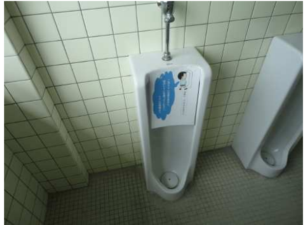
一部便器の破損あり
