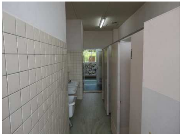
洋式トイレ（1箇所あり） 2階・3階は和式のみ、一部破損あり
