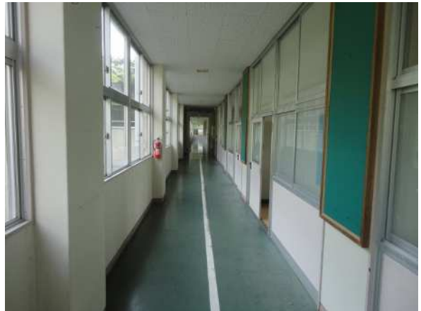
内壁に一部クラックあり 2階・3階も同様
