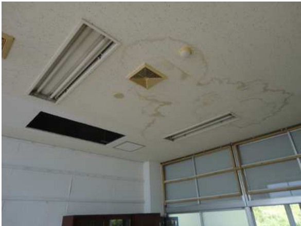
天井に配管からの漏水跡あり
