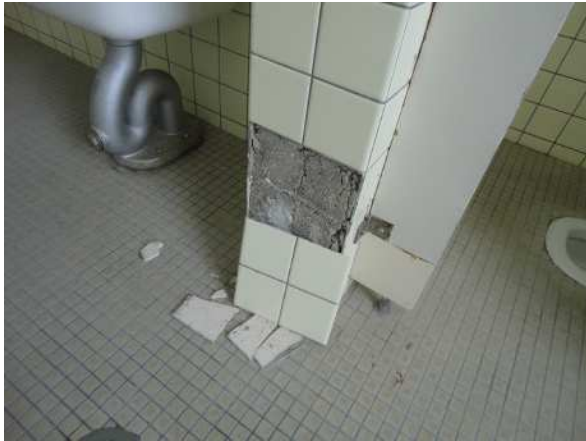
一部タイルの破損あり
